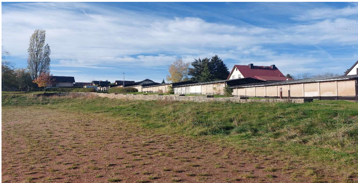
Abb. 19 Ansicht der vorhandenen maroden Natursteinmauer in Richtung Süd-West Bildquelle: Ingenieurbüro Hubert Beyer
